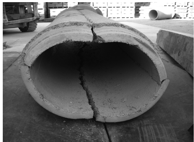
Figura 5. Patrón de fisuración en rotura en THFA. Cortesía de PREFRAGA
